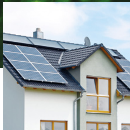
MODUŁY I INWERTERY FOTOWOLTAICZNE
